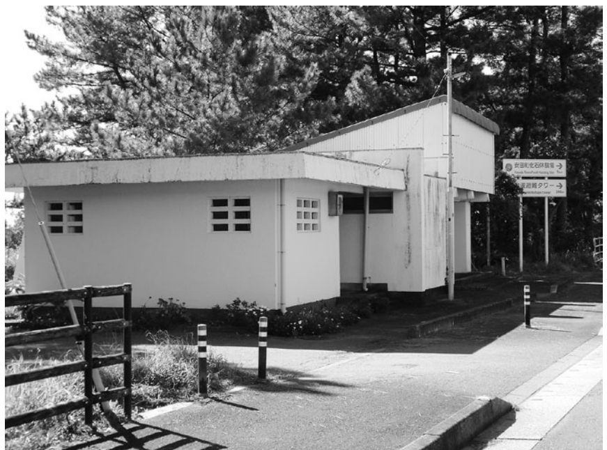
老朽化した唐浜西トイレ
