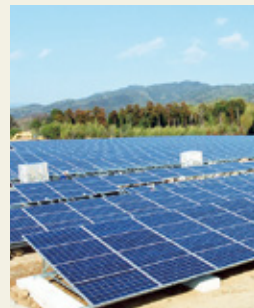
建設中のメガソーラー
