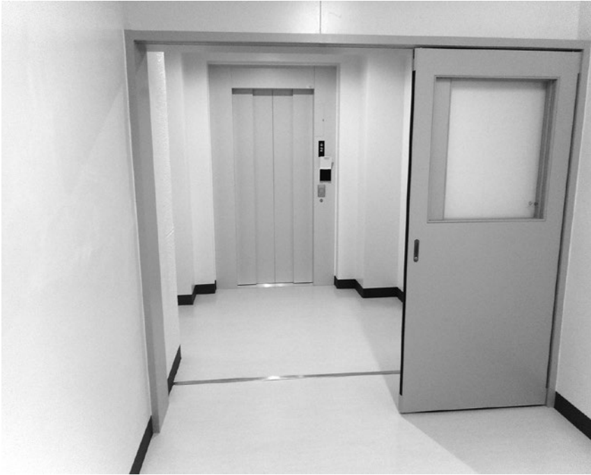
中学校に設置されたエレベーター
