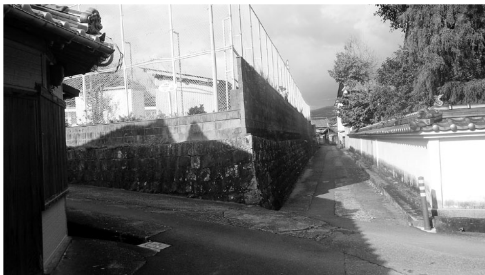
倒壊が心配されるブロック塀
